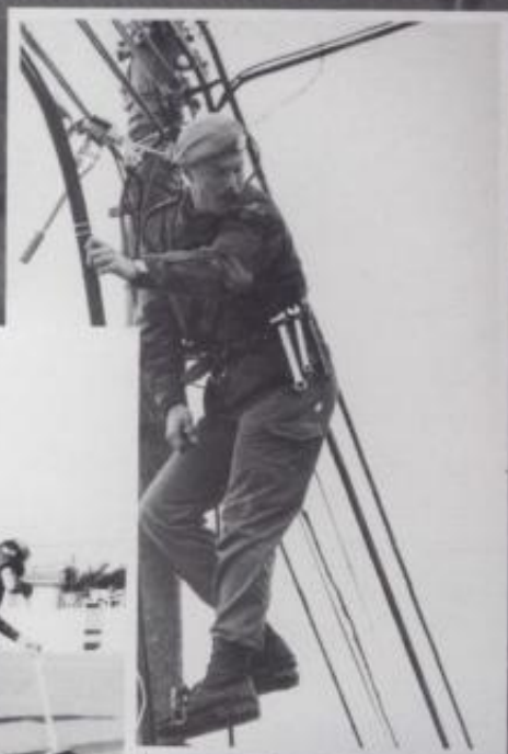
Vedlikehold av leirns elektriske anlegg.
