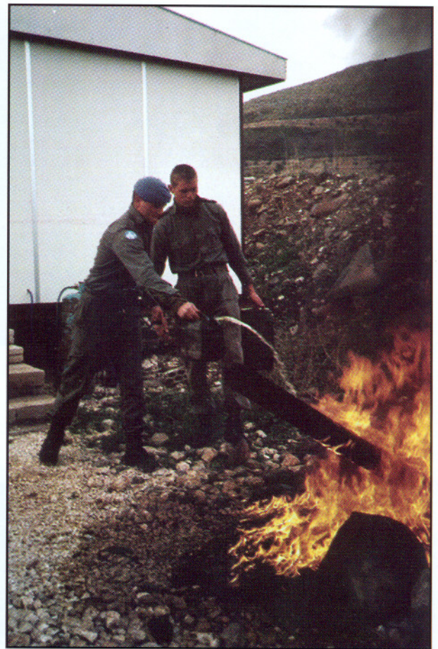
Brenning av PI-rør. Rekdal og Olsen ser ut til å gå inn for oppgaven med liv og lyst!
