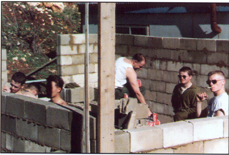
Innsatsvilje! Joda, det har vi! Her skal vi bygge tørke/trimrom i 4-25 LL. Dette skal gjøres ved egen innsats. Bygget er ferdig, unntatt taket som bataljonen skal sette opp.
